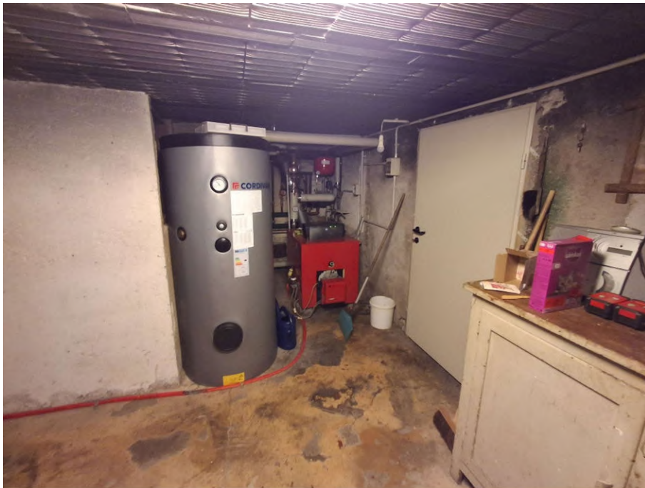
Vista locale caldaia p.t.
